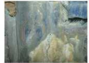
Capa de carbonatos y depósitos adheridos que oculta la superficie original
